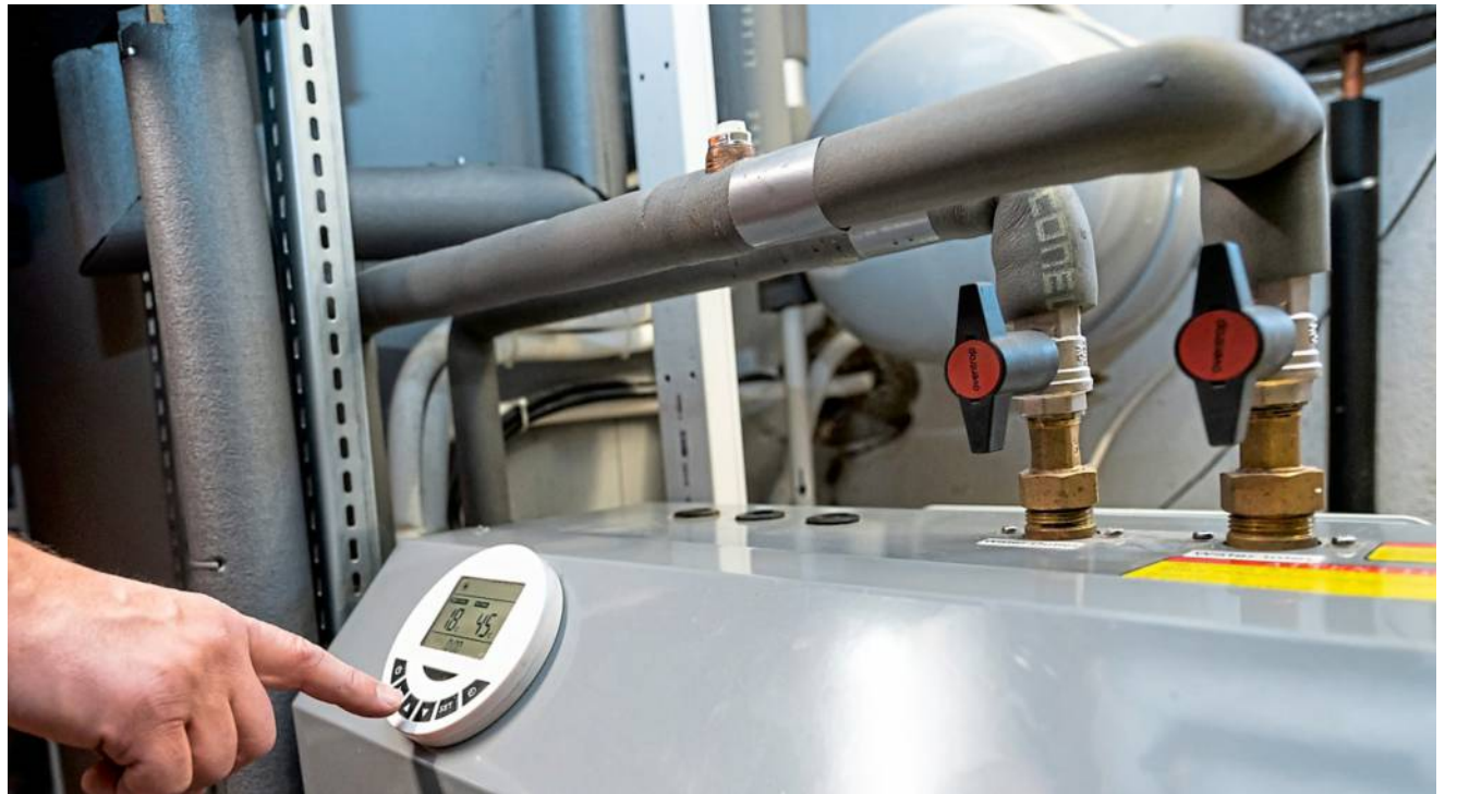
Schöne neue Heizungswelt? Bedienelement einer Luftwärmepumpe.
