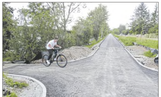
Das geht flott! Der Radweg auf der ehemaligen WEG-Trasse in Vaihingen ist in weiten Teilen schon asphaltiert. Das Befahren ist aber noch nicht zu empfehlen, denn die Brücken sind ja noch Baustellen beziehungsweise fehlen.
